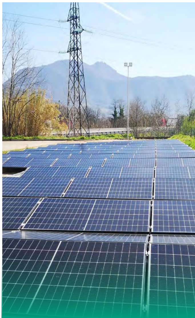
Paneles solares en la planta de Caserta, Antolin Italia.
